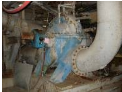
Fan Pump Discharge
